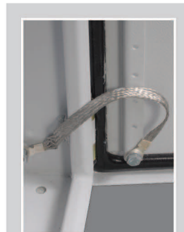
接地线 Grounding wire
